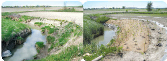
À GAUCHE - Problèmes d'érosion Projet ruisseau Richer À DROITE - Travaux de reprofilage et stabilisation Projet ruisseau Richer
